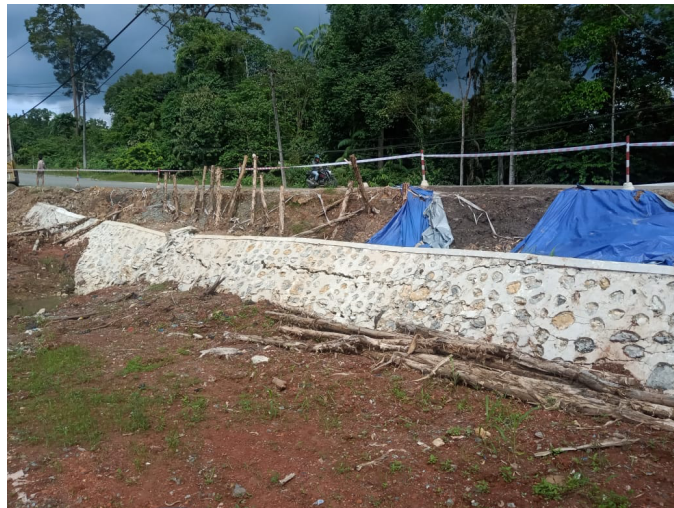
Gambar 1. Longsor Lereng Jalan Poros Samarinda – Bontang Sta. 3+450
